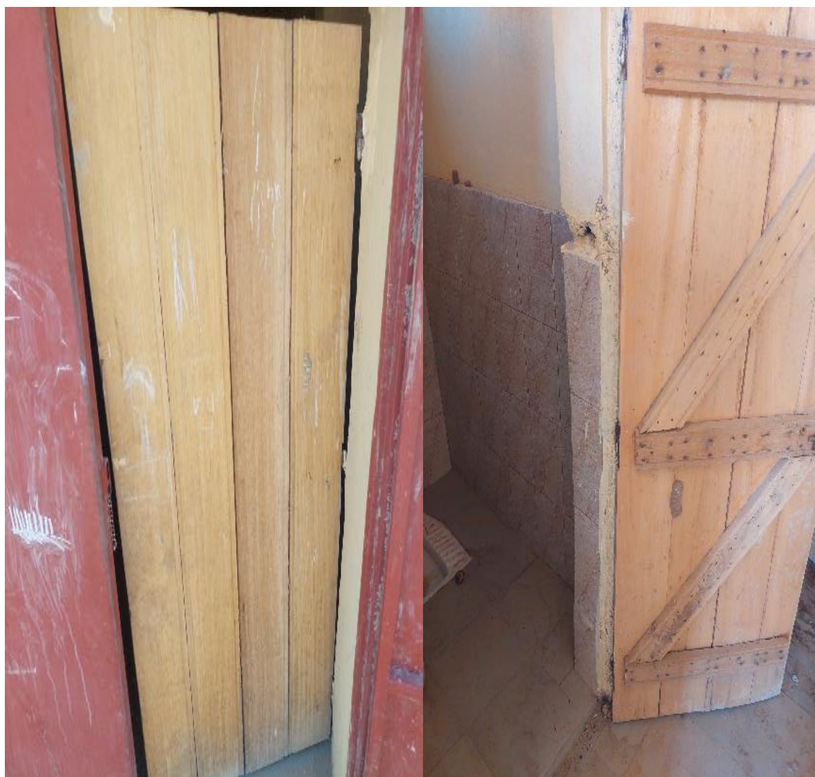
Image 5 : Région de Kaffrine : Absence de peinture sur les portes
