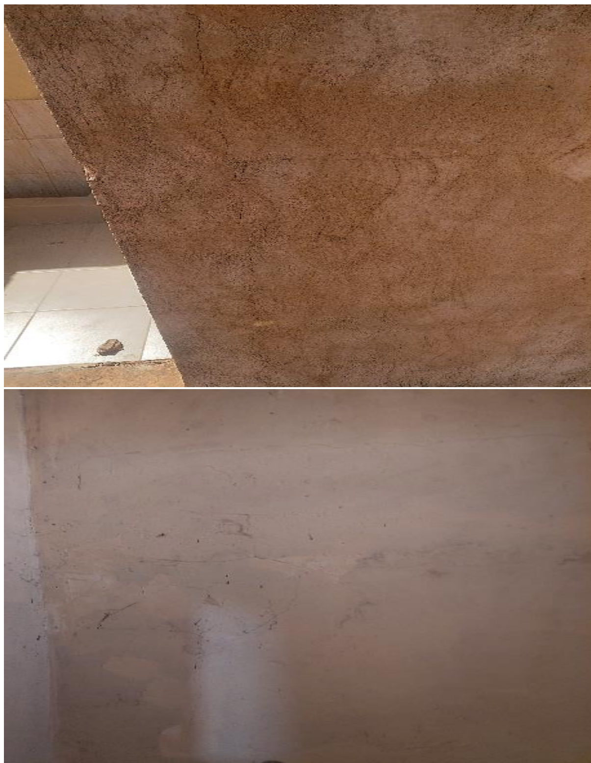
Image 7 : Région de Kaffrine : Fissures sur les murs
