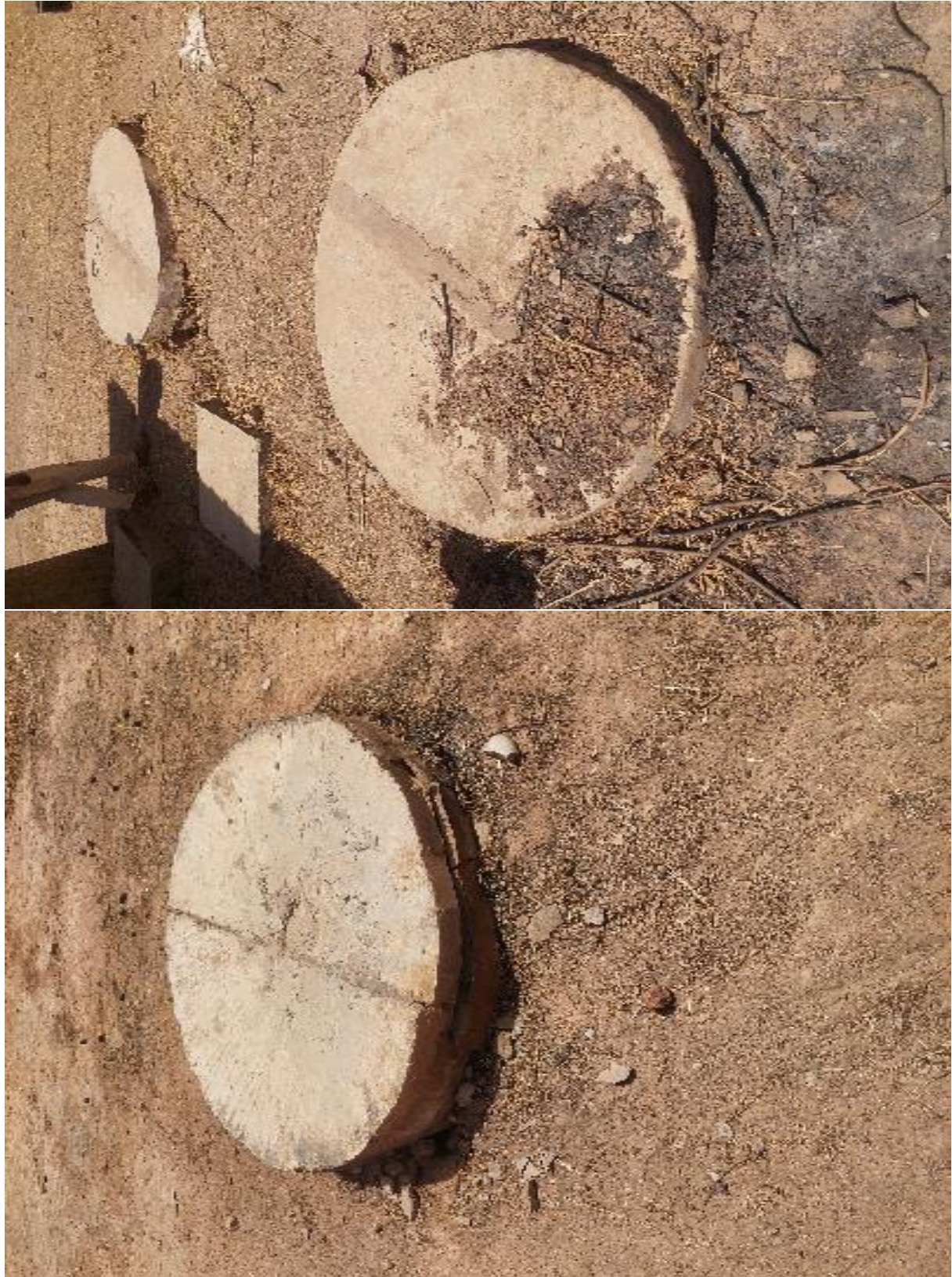
Image 1 : Absence de trappes de visite sur les fosses et puisards
