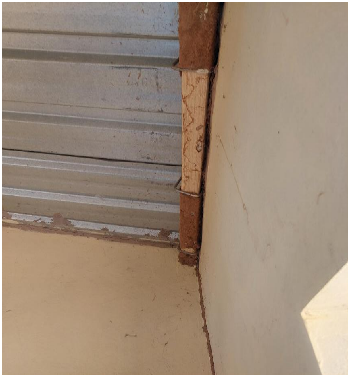
Image 6 : Région de Kaffrine : Insuffisance de tirefonds au niveau des toitures
