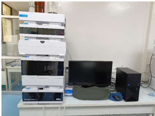
Les équipements déjà installés dans laboratoire. Les équipements ne sont pas encore opérationnels.
