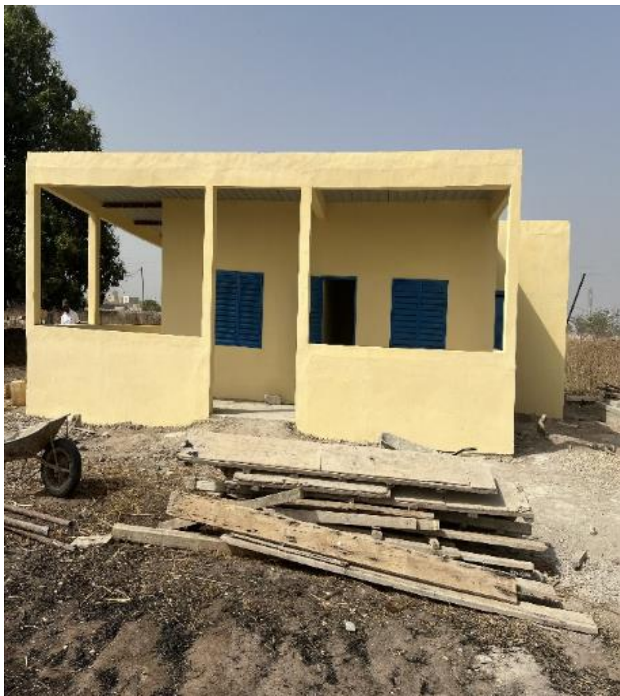
Image 5 : Apparition de fissures sur le mur du logement du gardien à Felane Sine
