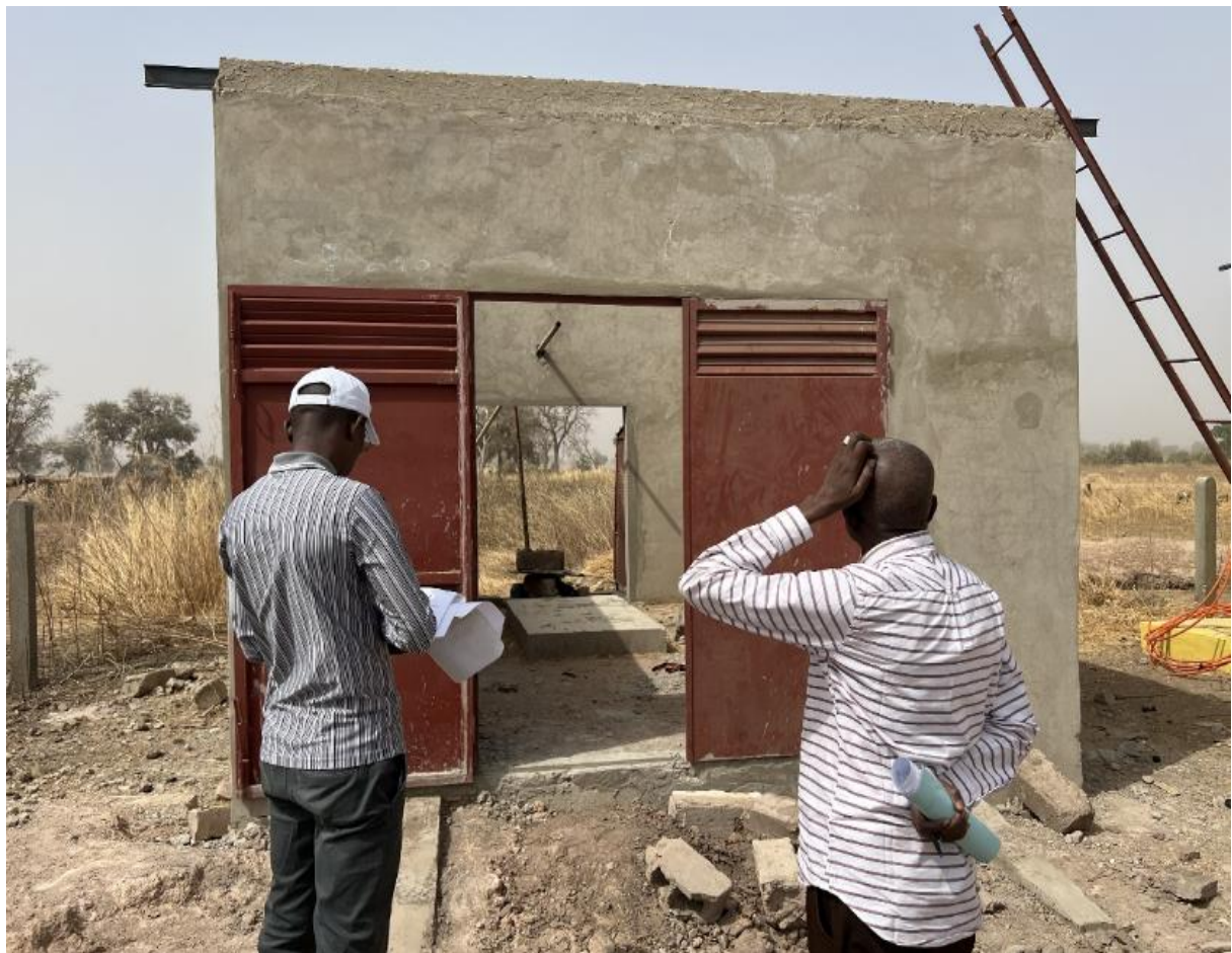
Image 7 : Non-conformité des bèches posées à Felane Sine
