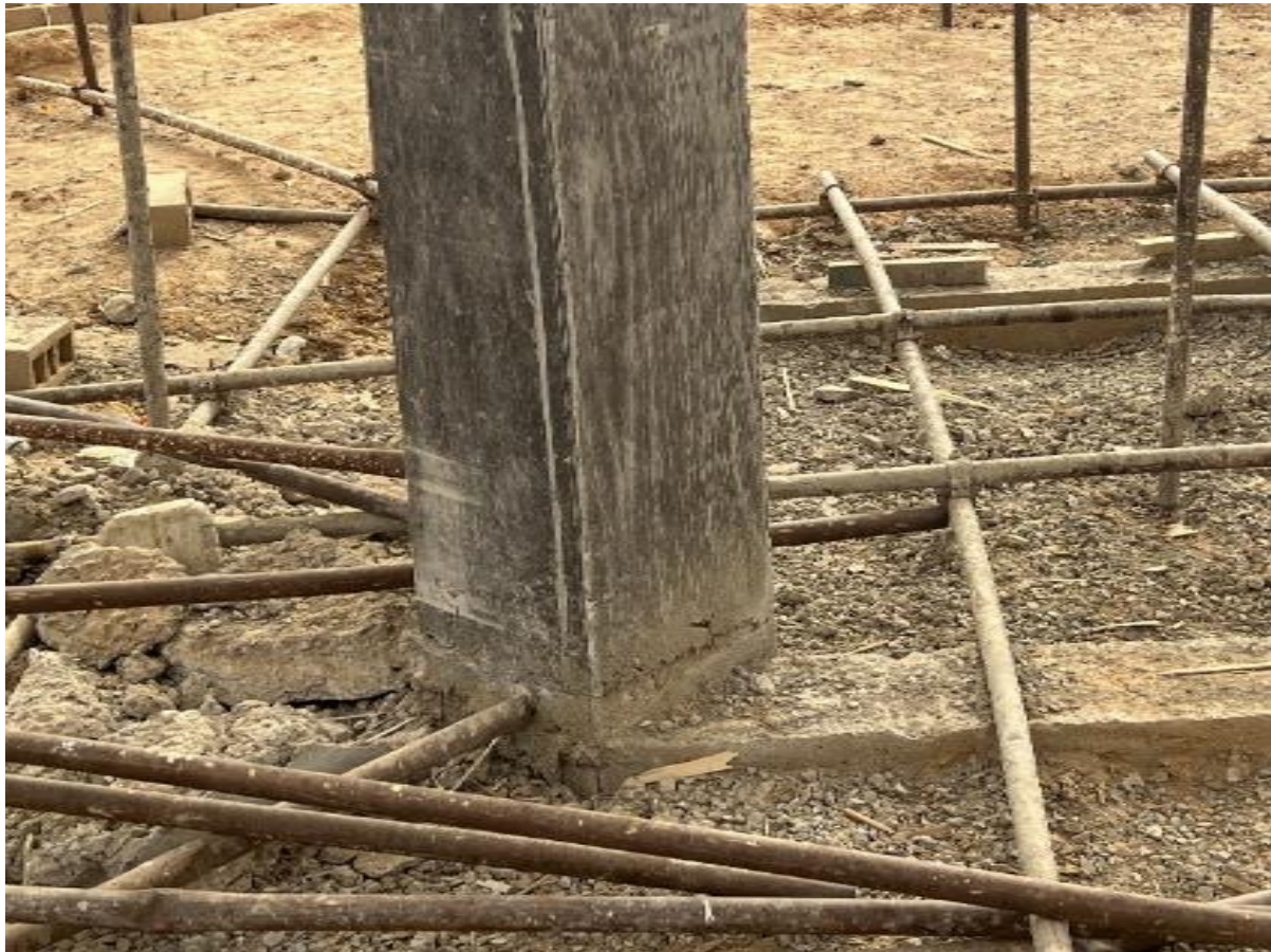
Image 3 : Apparition de ségrégation sur les poteaux et poutres
