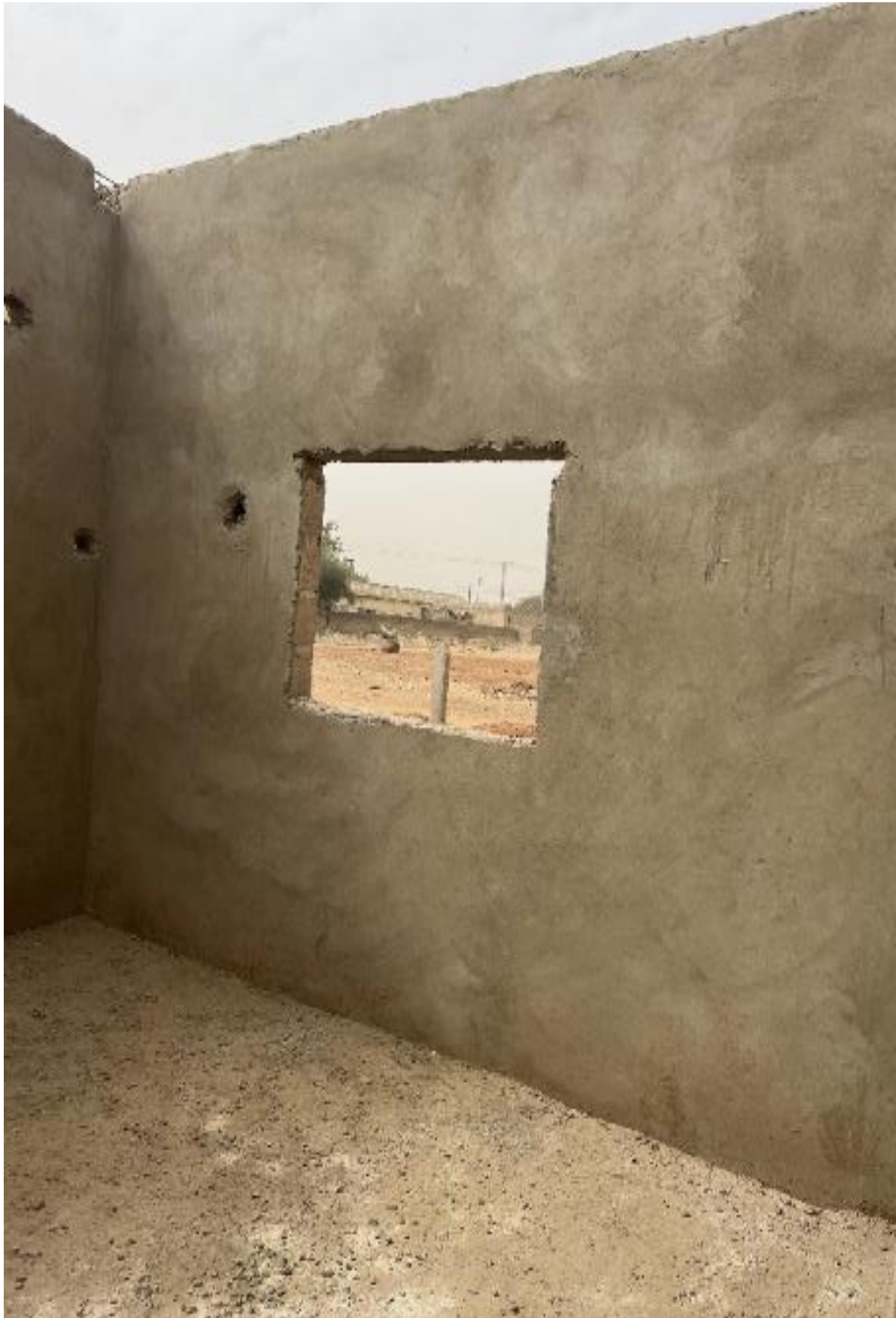
Image 4 : Apparition d'un décalage au niveau du dallage sol
