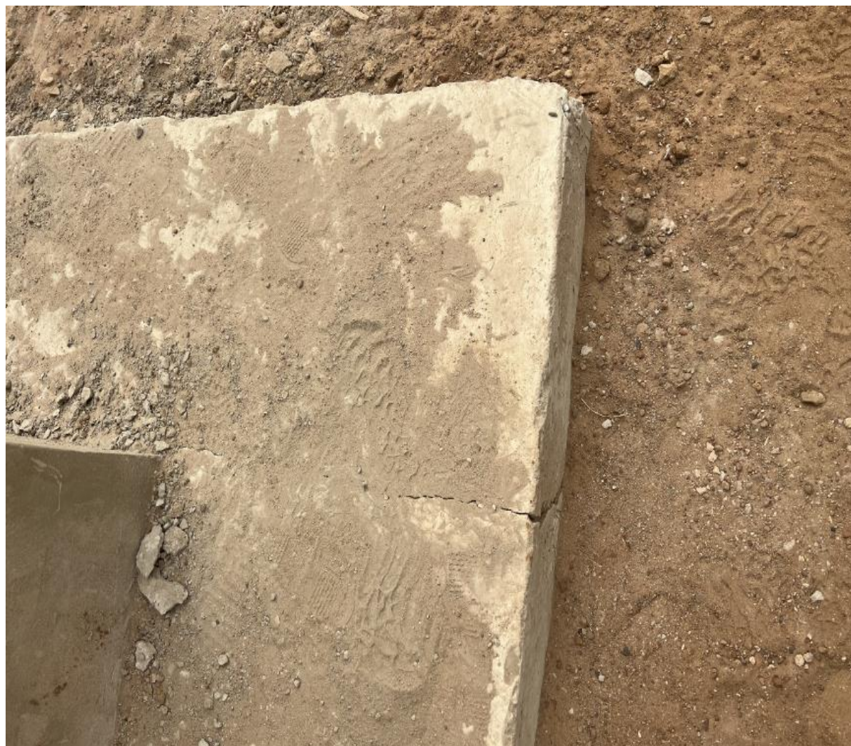
Image 2 : Apparition de fissures sur les revers d'eau
