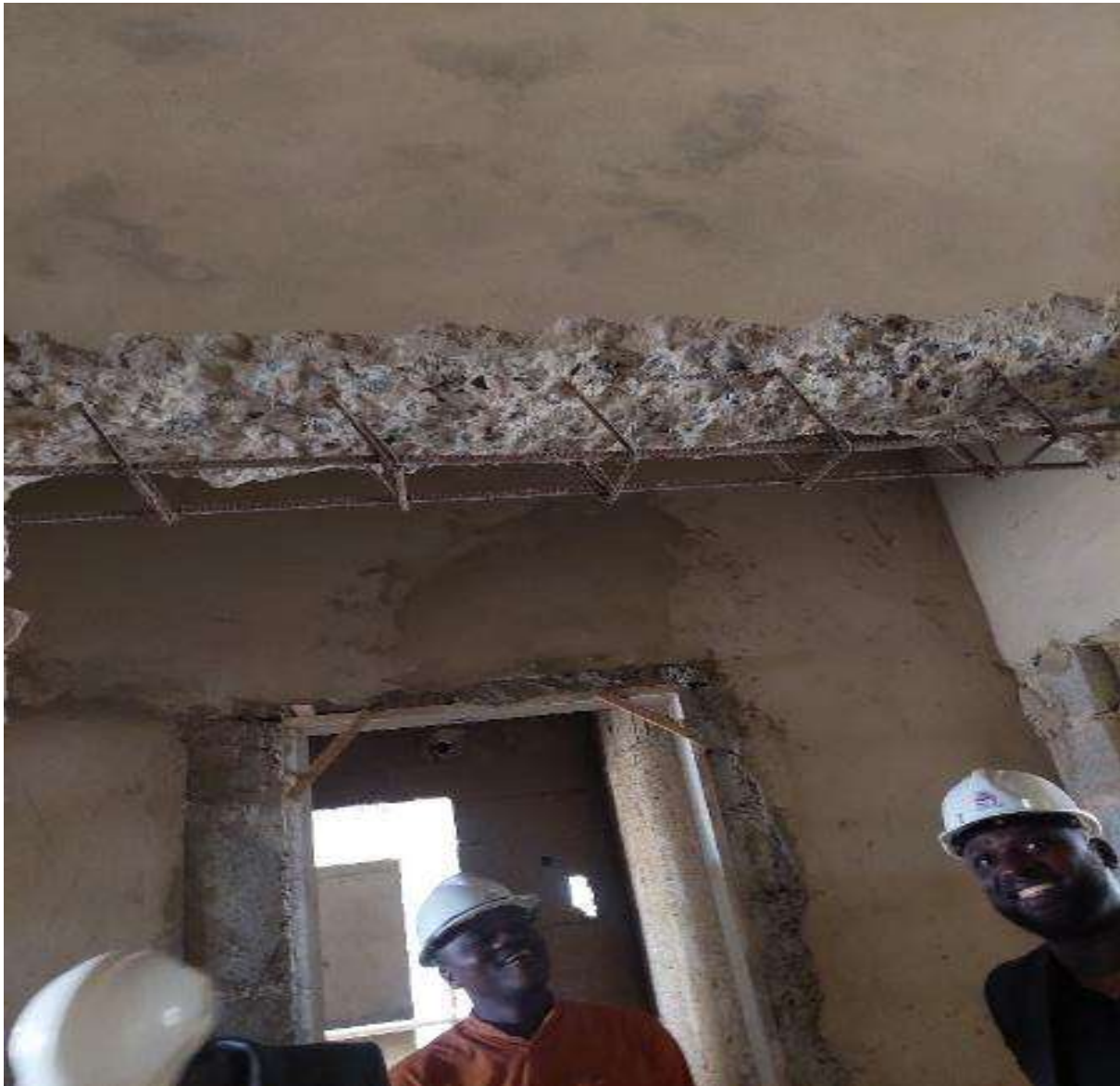
Image 2 : Anomalie sur le linteau
