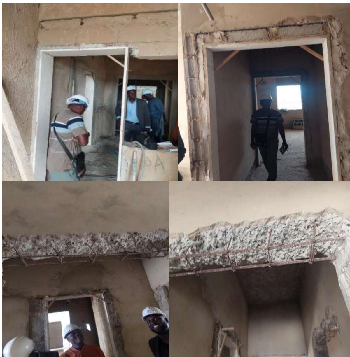
Image 5 : Non-conformité au niveau du linteau
