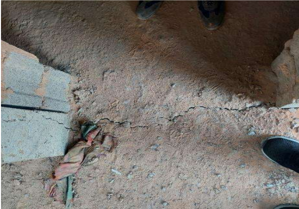
Image 4 : Apparition de fissures au niveau du plancher
