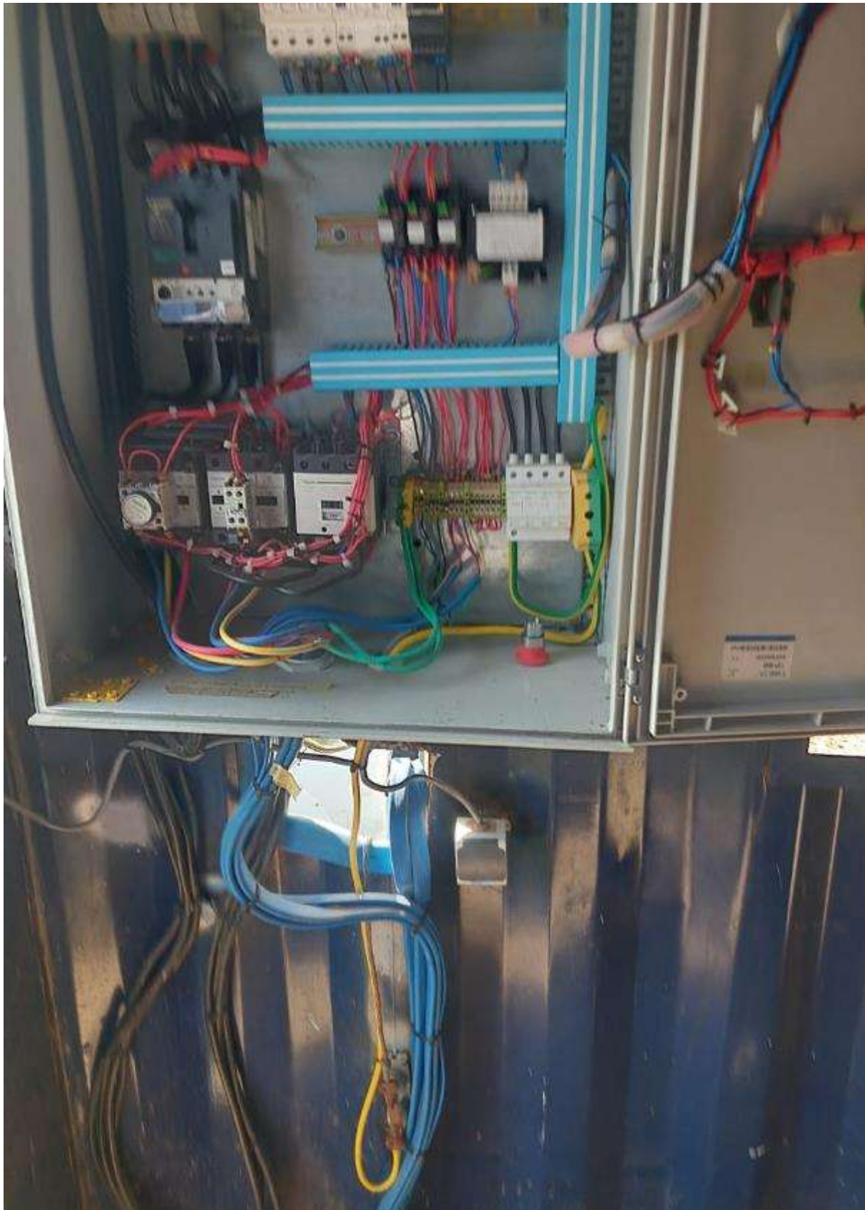
Image 4 : Conteneur de pompage
