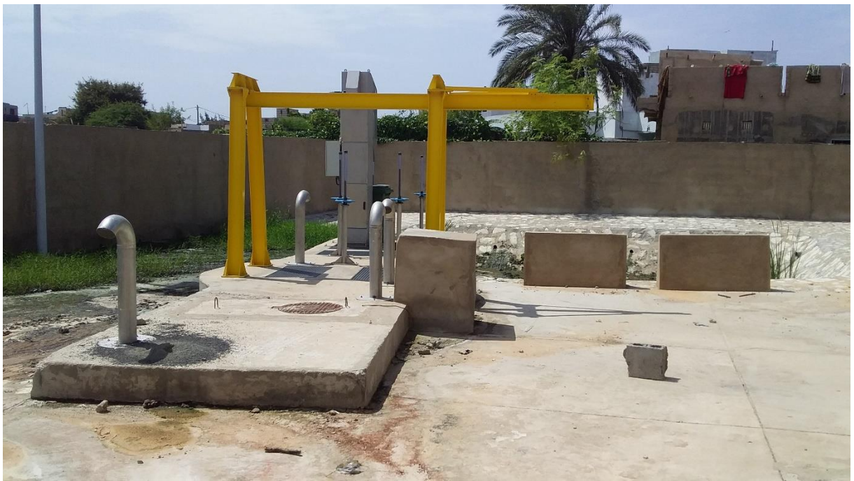
Centre d'épuration de la commune de Keur Massar situé dans le quartier de Fass. Il est réalisé par l'ADM dans le cadre du PROGEPI
