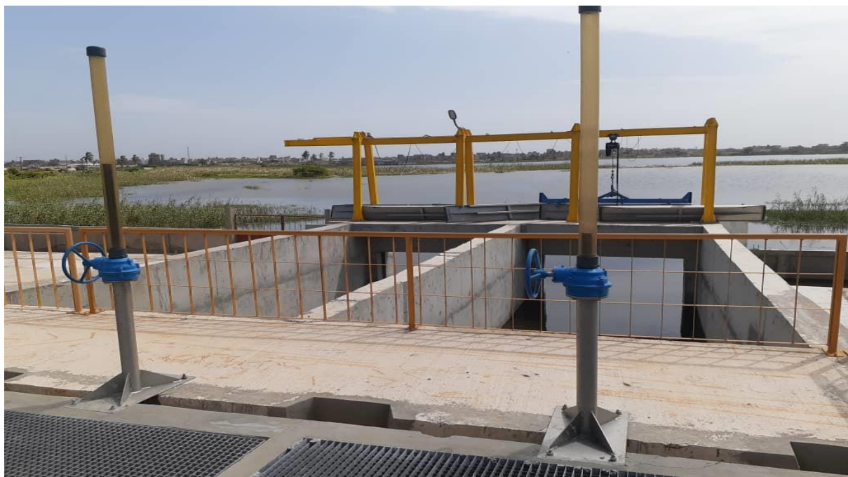
Station d'épuration de Mbeubeuss de la commune de Keur Massar réalisée par l'ADM dans le cadre du PROGEPI
