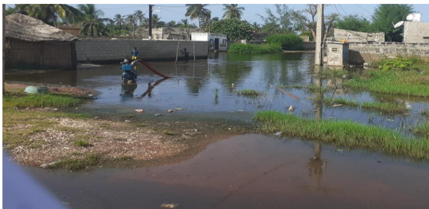
Photo : Commune de Palmarin/ site inondé, évacuation des eaux par pompage par les sapeurs-pompiers.
