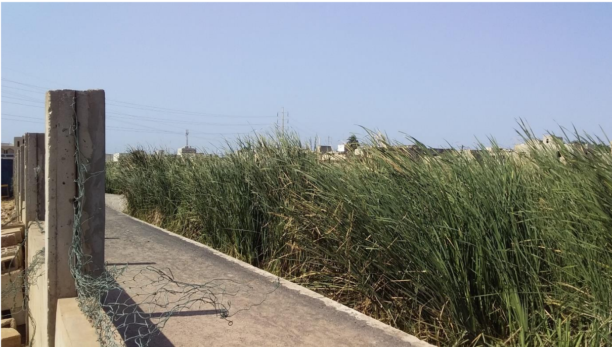
Bassin de rétention envahi par le Typha à Diamagueune Sicap Mbao
