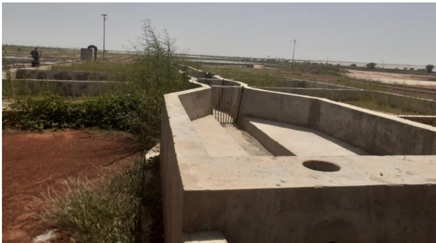
Photo : Station d'épuration des eaux usées d'une capacité de 800 m 3 /h et de traitement des boues de vidange d'une capacité de 30m 3 /h. Cependant, la station de traitement des boues de vidange n'est pas encore fonctionnelle en raison du retard dans le raccordement de la station au réseau d'approvisionnement de la SONES. Il est dès lors proposé l'utilisation des citernes d'eau jusqu'à l'exécution du raccordement.
