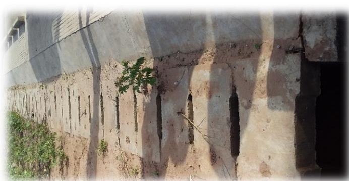
Canalisation le long de la voirie
