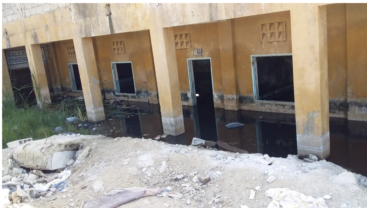
Ecole Sam Sam 3 (Commune Diamagueune Sicap-Mbao). L'école est inondée depuis les inondations de 2005. Sur les 17 classes que compte l'école, 6 sont fonctionnelles.
