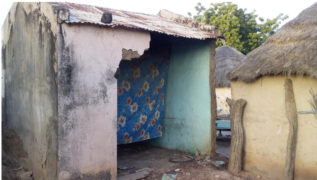
Effondrement de cases occasionné par les fortes pluies de cette année au quartier Taïba dans la Commune de Malem Hodar.
