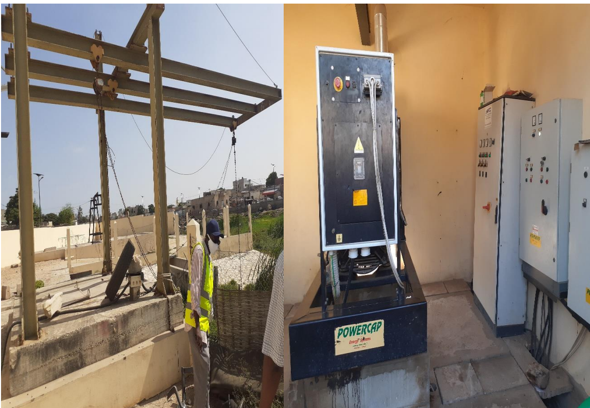
Photo : Station de Pompage de Medina Gounass/ mis à niveau dans la cadre de la phase 1 du PROGEF augmentation d'un deuxième système de pompe.
