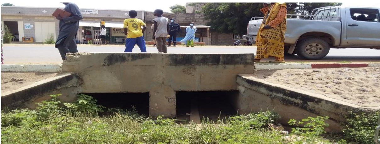
Ouvrage de franchissement qui fait partie du réseau de canalisation pour le drainage des eaux pluviales de la commune de Kaffrine (PDLI)
