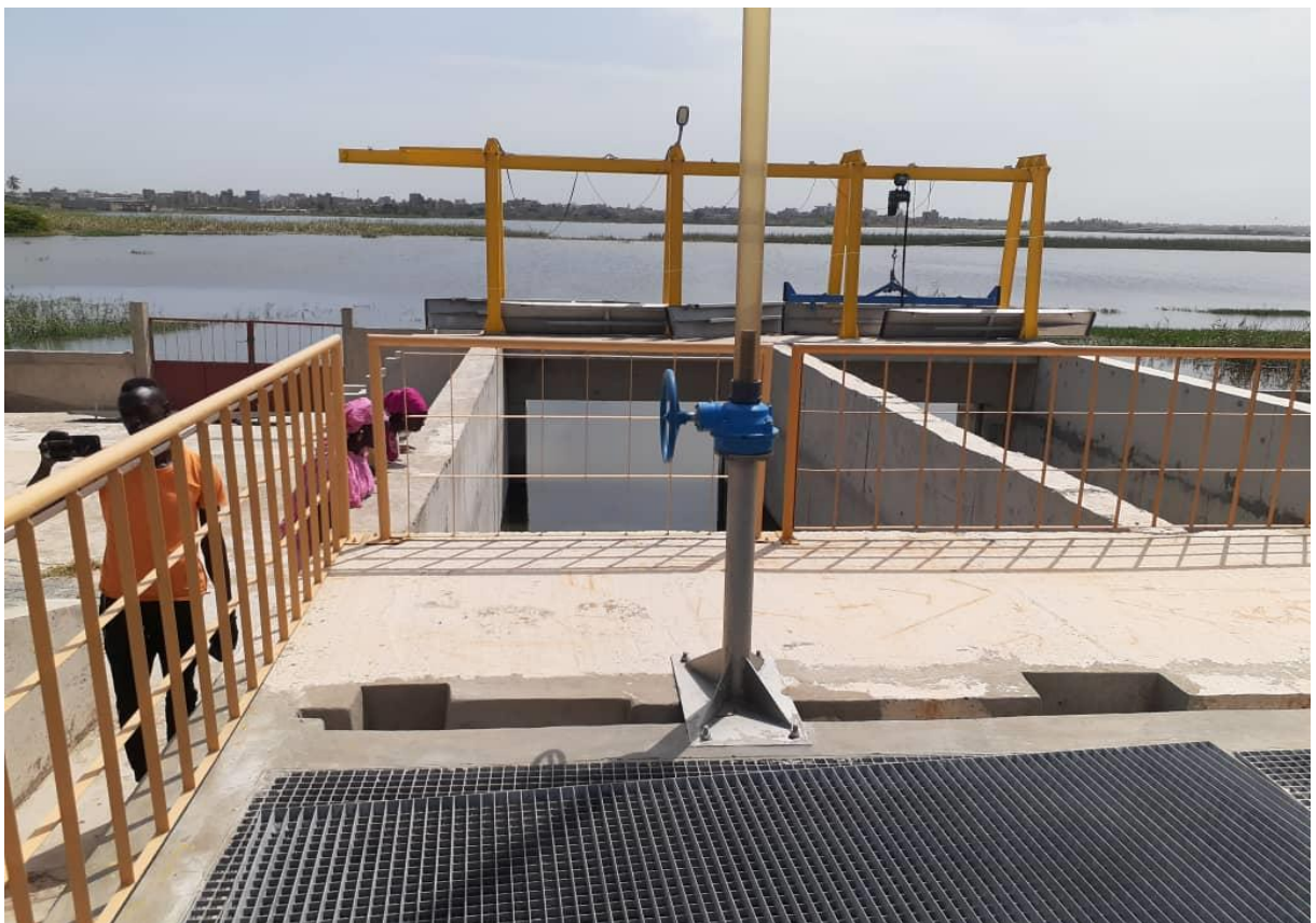
Station d'épuration de Mbeubeuss de la commune de Keur Massar réalisée par l'ADM dans le cadre du PROGEPI
