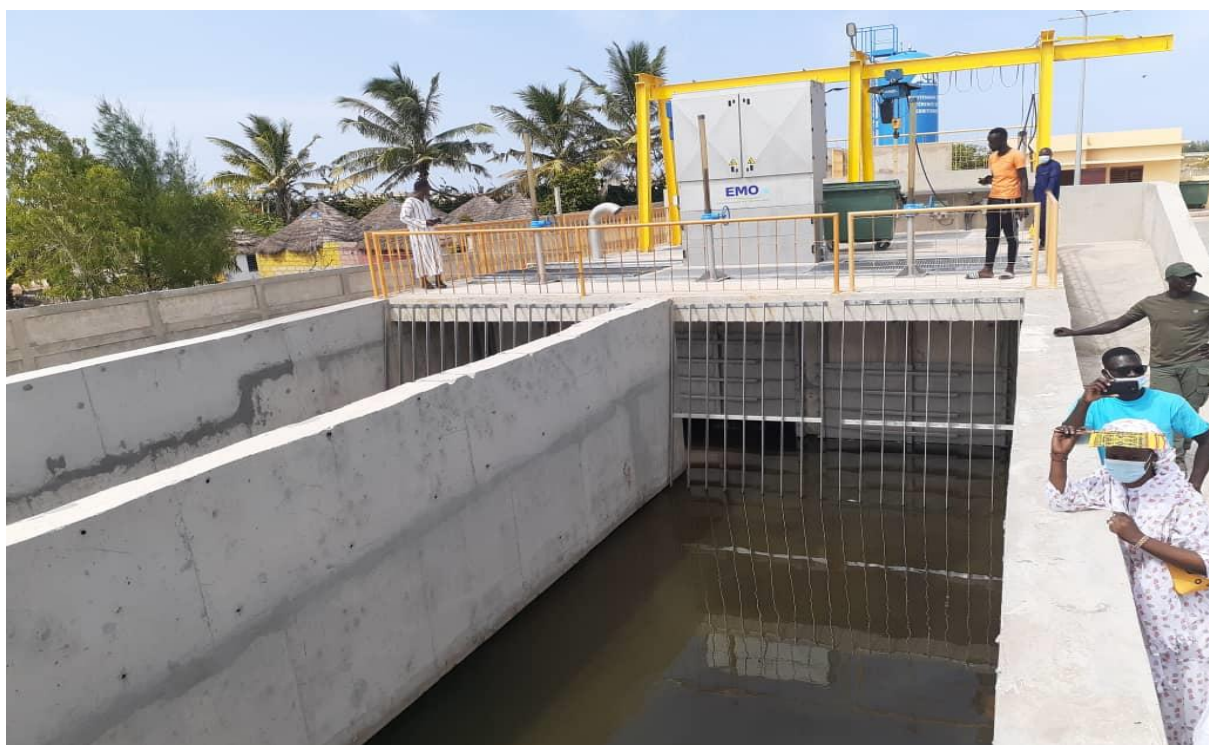
Station d'épuration de Mbeubeuss de la commune de Keur Massar réalisée par l'ADM dans le cadre du PROGEP 1
